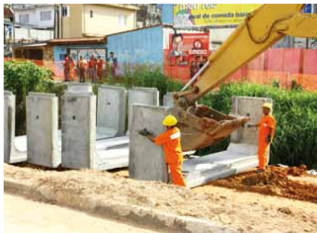
Canalização de córrego João Alves e duplicação da Av. Visconde de Nova Granada (em andamento)
